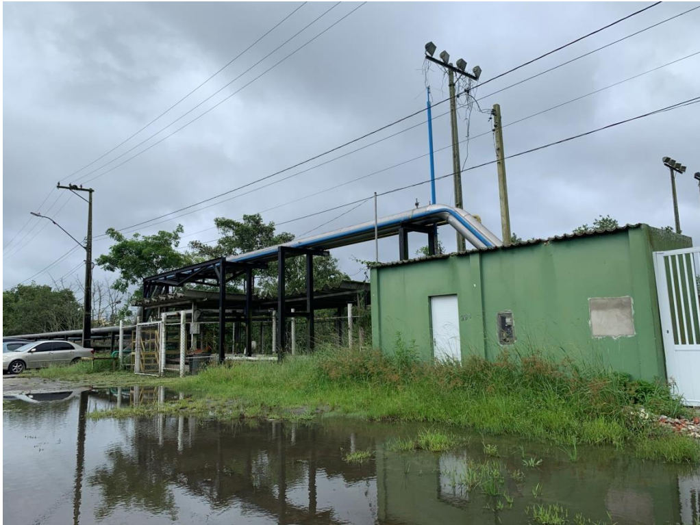
Figura 4: Afloramento do duto após o cruzamento com a Av. Cel. Santa Rita.
